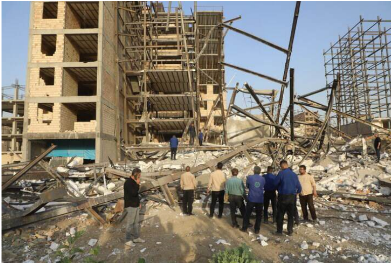
شکل ۱-۸- تخریب غیر اصولی
