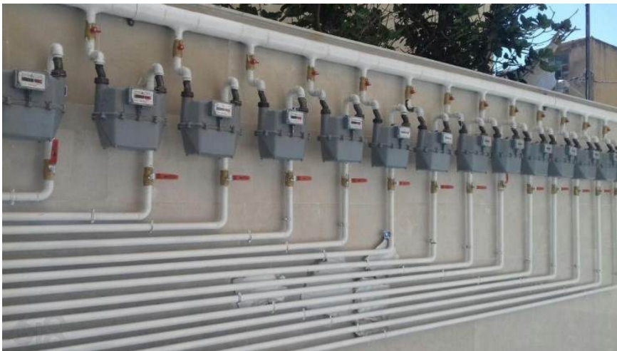
شکل ۱۱-۲- نمایش کنتورهای یک پروژه مسکونی
