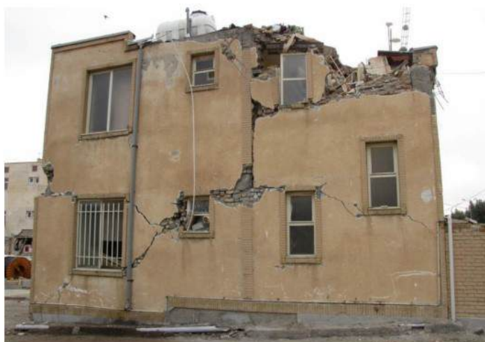
شکل (۶-۱۹): فروپاشی موضعی در یک ساختمان مصالح بنایی کلاف دار
