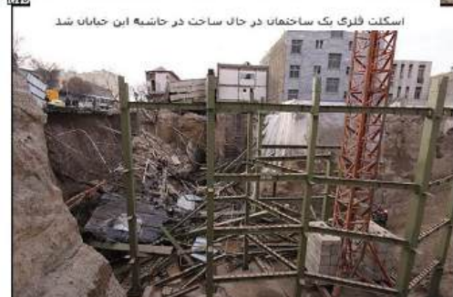
گودبرداری غیر اصولی موجب نشست بخشی از خیابان رگ زهران و فرو ریختن
