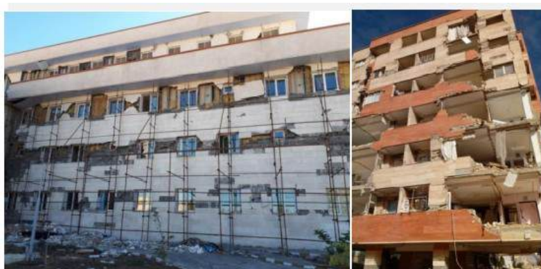
شکل (۱-۸): خطر فروریزش نمای ساختمان
