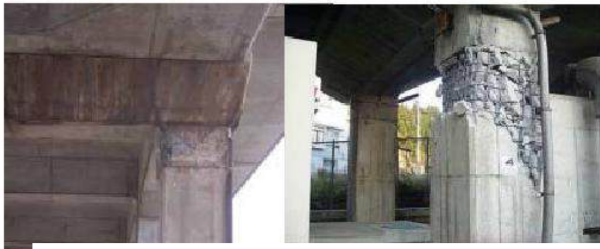
شکل 1- نمونه ای از آسیبهای سازه ای در پایه پلها در هنگام زلزله (زلزله سانفرانسیسکو)
