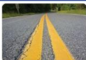
#1 ترک خوردن حرارتی آسفالت Feedar Estahan www.iranbitumen.co
