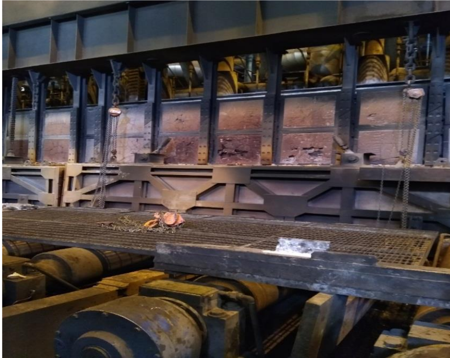
شکل ۳، دیواره مجاور خط انتقال تختال های فولادی گرم
