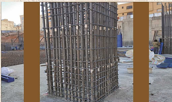
ستون با وصله های مکانیکی با اجرای صحیح
