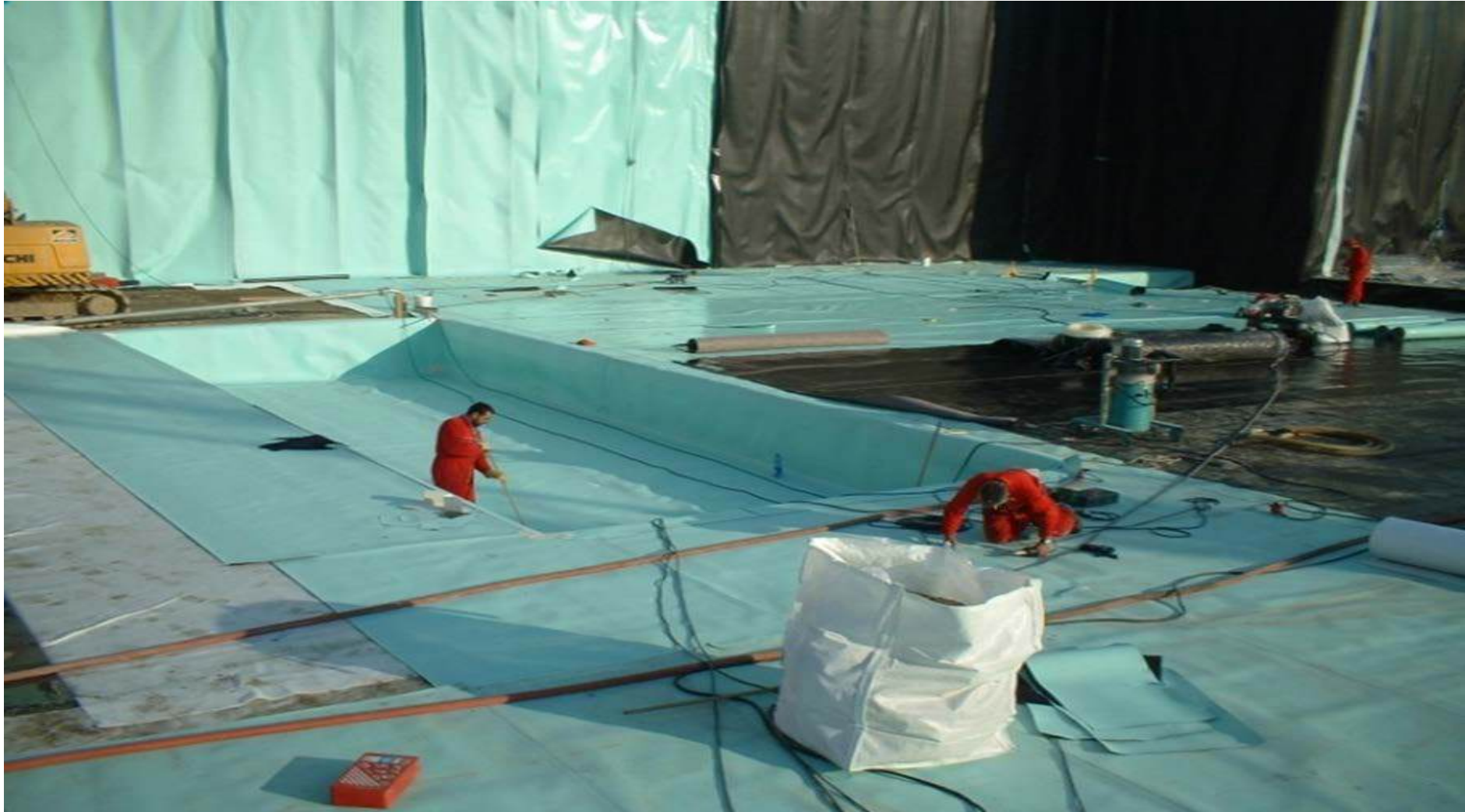
ایستگاه مترو شهر رم - وکیوم سیستم
