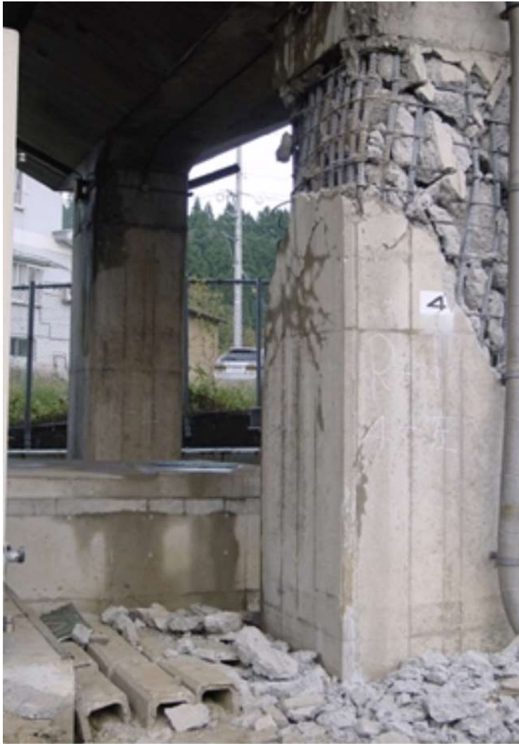
نمونه ای از پایه ی آسیب دیده ی پل
