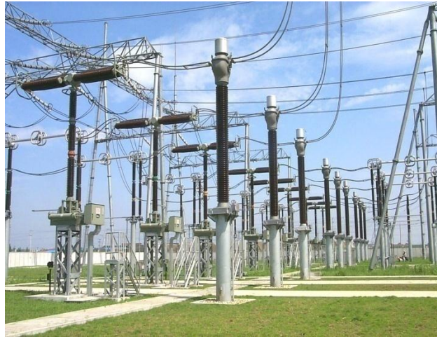
شکل شماره ۵: نمونه ای از پست الکتریکی، ماخذ: شرکت توزیع نیروی برق استان مرکزی
