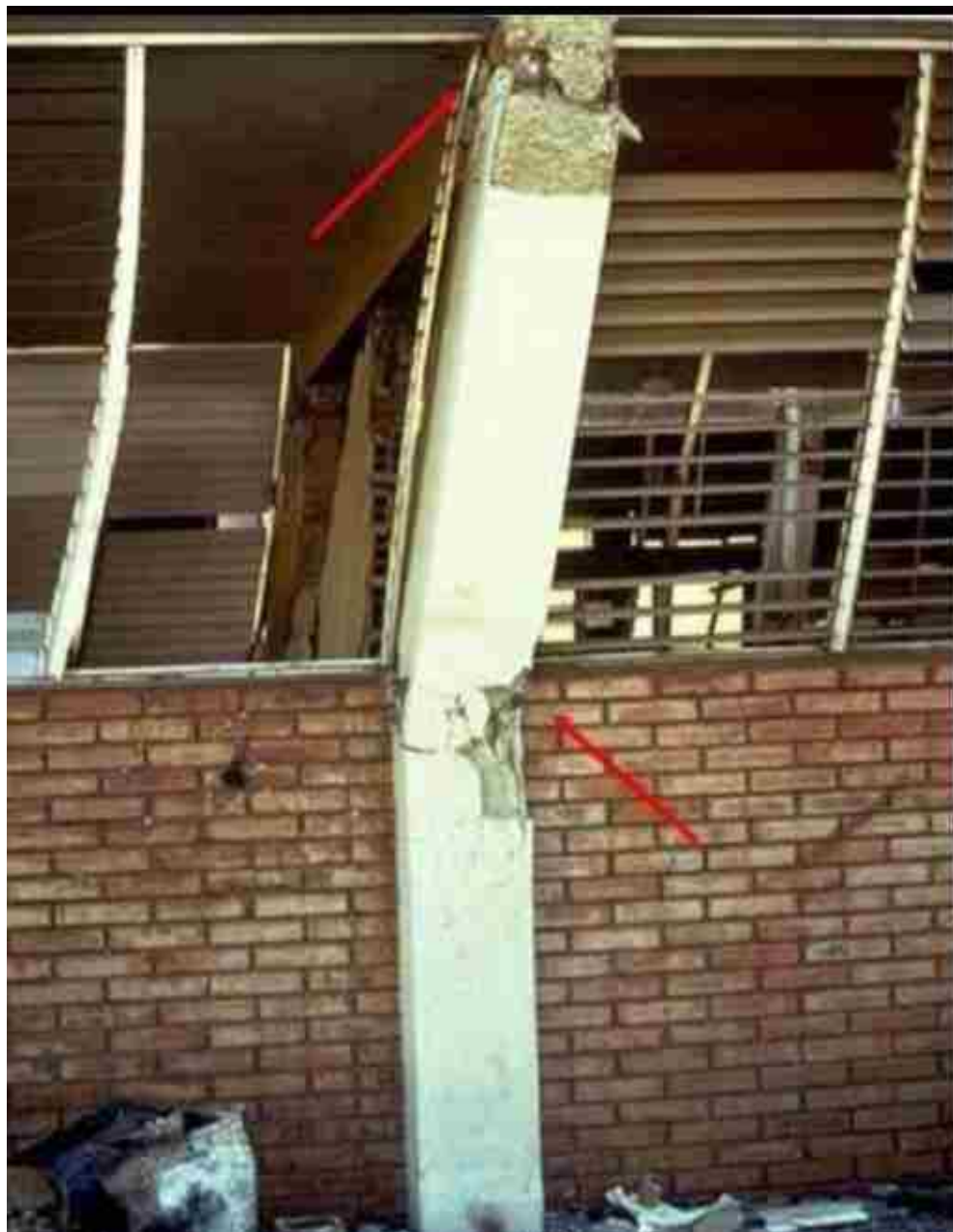
شکست برشی ناشی از تشکیل ستون کوتاه
