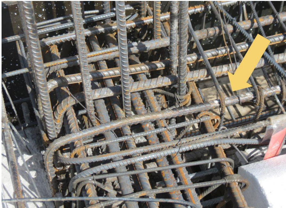
شکل ۱۴. عدم عبور آرماتور طولی تیر از هسته بتن.
