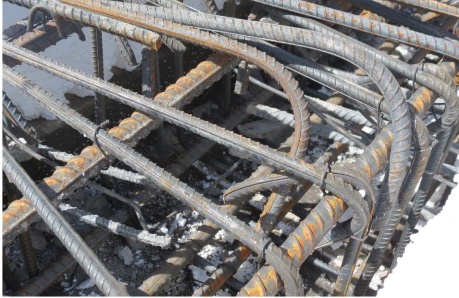
شکل ۱۵. قلاب نامناسب آرماتورهای تیر.
