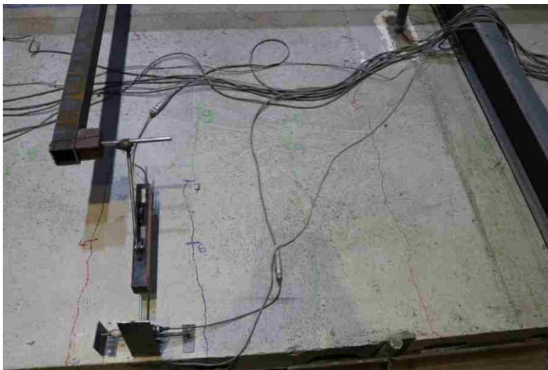
شکل ۵-۵۱ - ترک‌های خمشی ایجاد شده در ناحیه میانی دال
