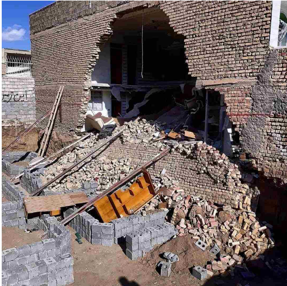
تصویر شماره ۳- ریزش گود
